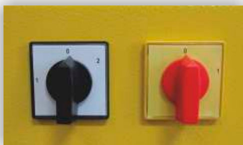
Panel hlavního vypínače
